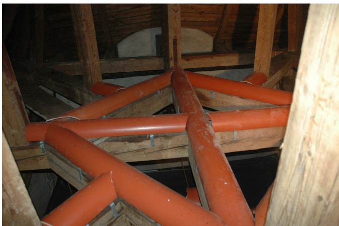
Ochrana trámů v kostele ve Velké Bystřici.
