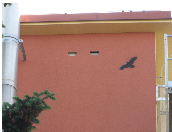
Budky v zateplení domu v Bystřici p. Hostýnem
